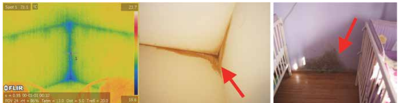
Slika 13. Termogram toplinskog mosta u izvedenoj NZEB obiteljskoj kući u Zagrebu (lijevo), prikaz posljedice toplinskih mostova (sredina i desno)
